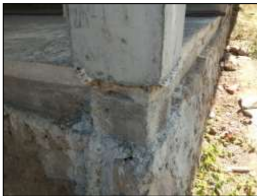
Gambar 2. Konstruksi Kolom yang tidak menerus kedalam pondasi hasil pekerjaan tukang local
